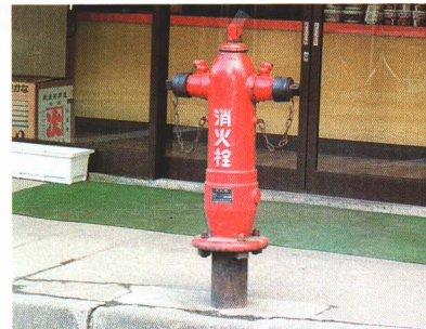
▲消火栓 (町内134か所)
