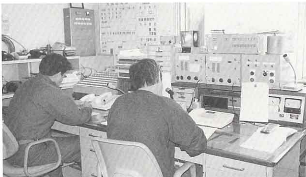
▲ 中央消防しょの指令室（通しん室）
