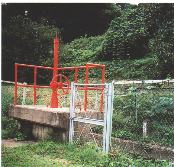
はいすいこう <排水口>～大雨のときにここを開いて堰の水を川にもどします。
