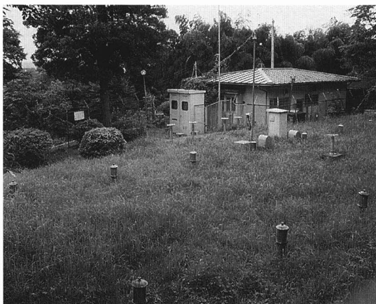
かめがいはいすいち 亀谷配水池
