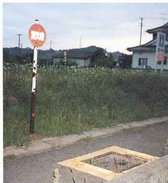
▲地下式消火栓 (15ヵ所)
