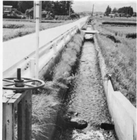
（せいびされた水路）
