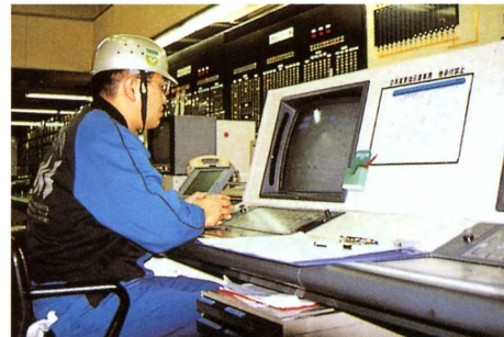
コンピュータ集中制御室
