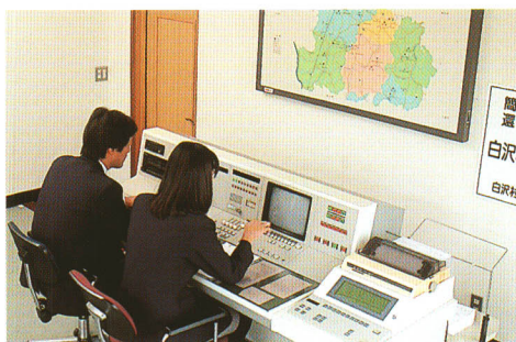
■防災行政無線システム
