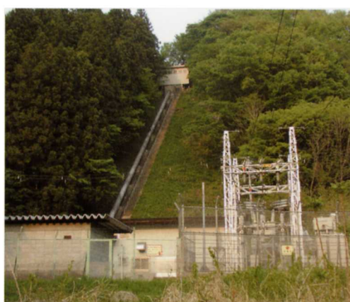
さわがみ ひろせ 沢上発電所 (旧名、広瀬発電所)
