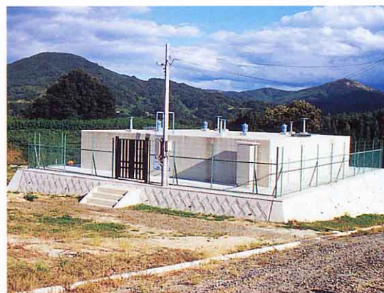
配水池(東和中前)
