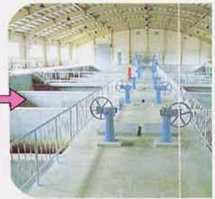
あほうそく 急速ろ過池
