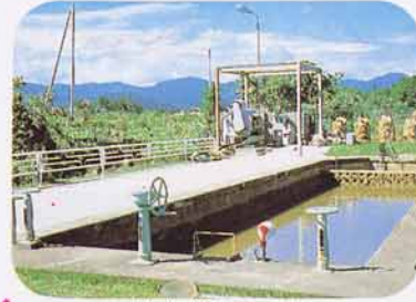
矢地内取水場
