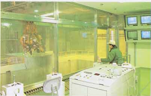
ごみクレーンそうさ室 ごみクレーンをえんかくそうさします。
