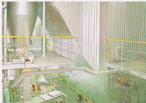
電気集じん機 けむりがほとんど出ないようにしています。
