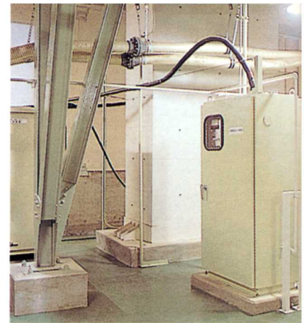
有害ガスの量をかんしする
