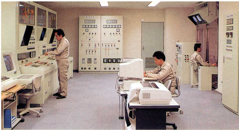
中央せいぎよ室
