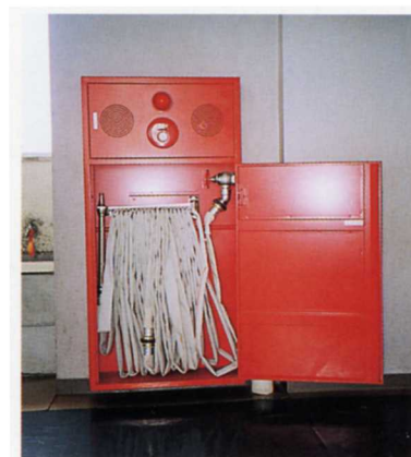
しょうかせん 消火栓 (学校)
