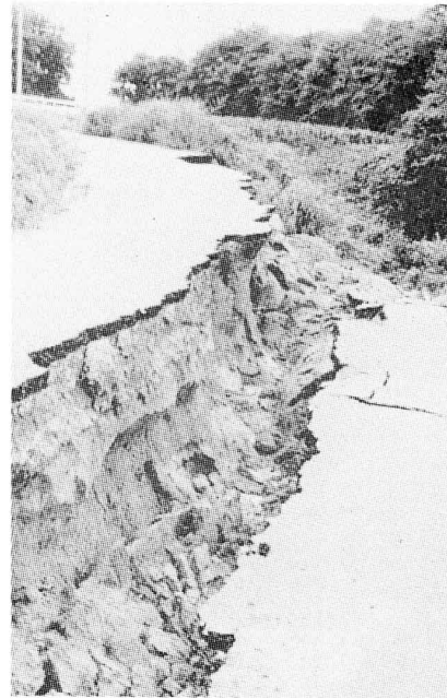
町道 せりが 芹ヶ沢—南原線での道ろくずれ さわ
