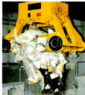
ごみクレーン
