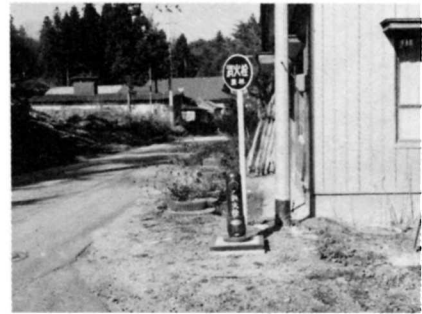
消火せん(石原地区)
