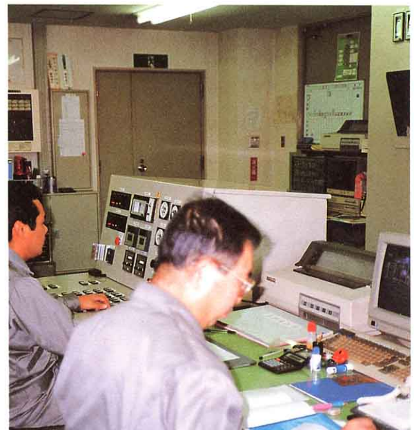
▲クレーンの そうき 操作や、ゴミの燃える じけんたい 状態をモニターテレビで監視している。
