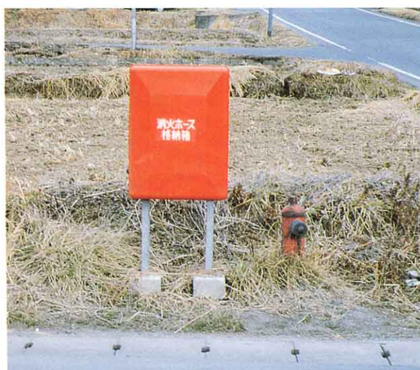
▲ おくがいしょうか 屋外消火ホース
