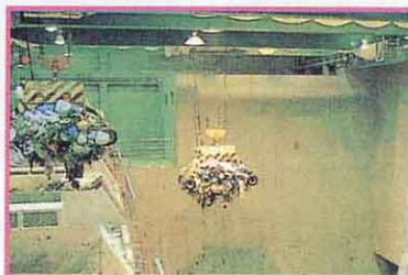
① ごみクレーン
