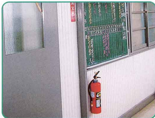
▲ 学校のいろいろなところにある消火器 しょうか き
