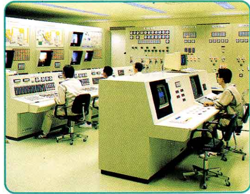
④ 中央せいぎょ室
