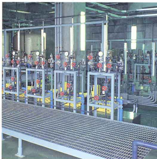
やくひんちゅうにゆうせつび 薬品注入設備
