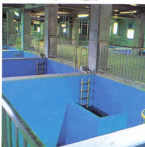
きゅうそくかち 急速ろ過池
