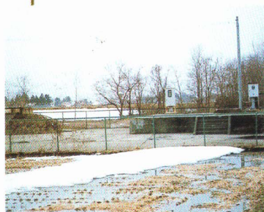
第3水源ポンプ場
