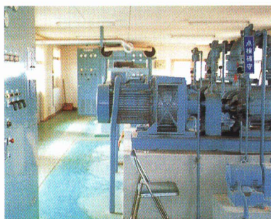
金川浄水場配水ポンプ場施設
