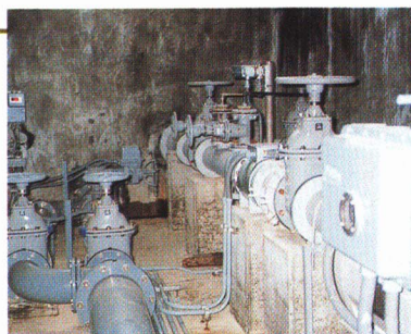
横道配水池場送配水管
