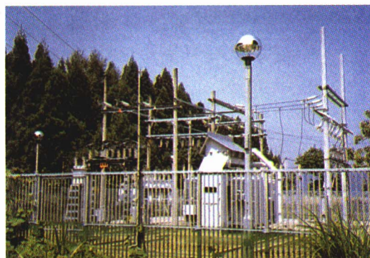
のざわへんでんしょ ▲野沢変電所
