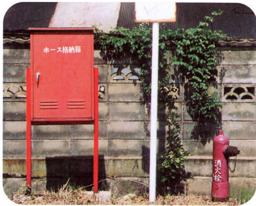
消火栓とホース格納箱
