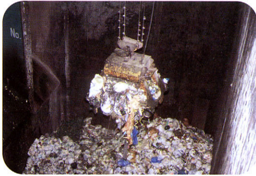
ごみピットとごみクレーン
