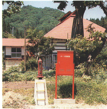
◀ホース格納箱と消火栓 かくのうばこ しょうか せん
