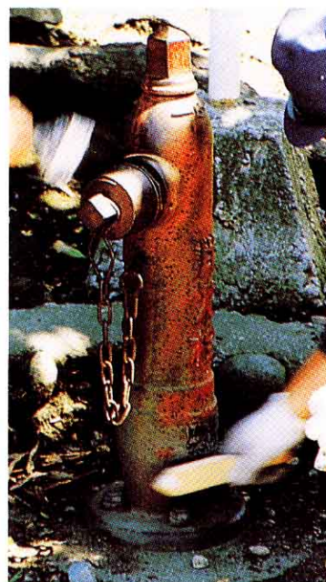
▲消火栓の点けん
