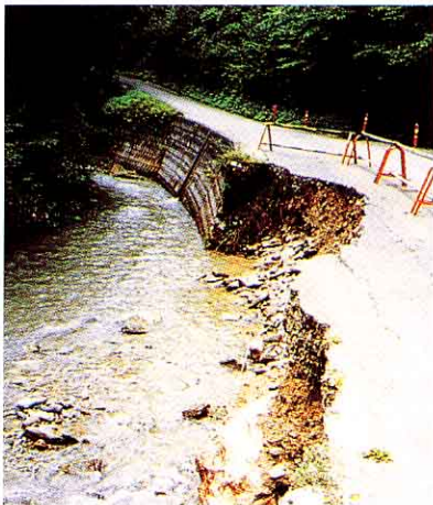
▲こわされた道路
