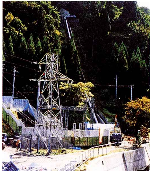
▲宮川水力発電所
