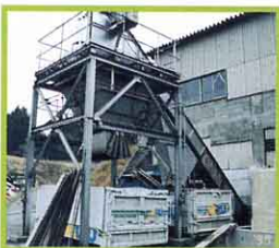
ごみをもやした後の灰を運ぶベルトコンベアー
