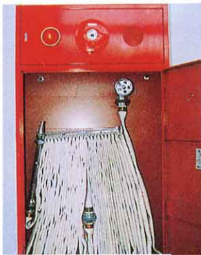
消火栓の内部
