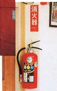
教室前の消火器
