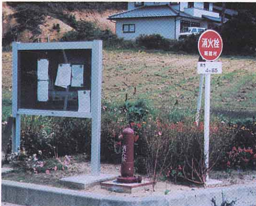
しょう か せん 消 火 栓
