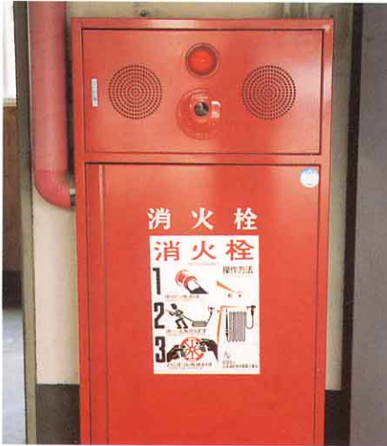
<消火せん・ポンプ>
