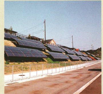
太陽光発電システム
