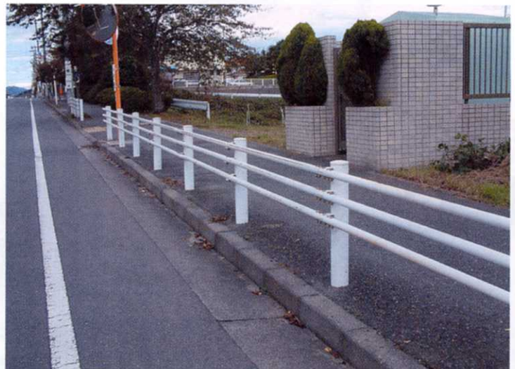
ガードレール
