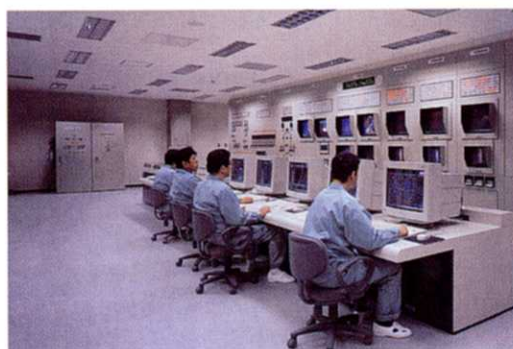
中央せいぎょ室 センター内の機械はすべてこの部屋で正しく動いているかをかんしします。
